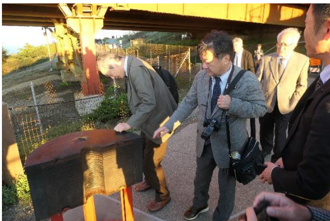
橋梁部材の変状についての展示
